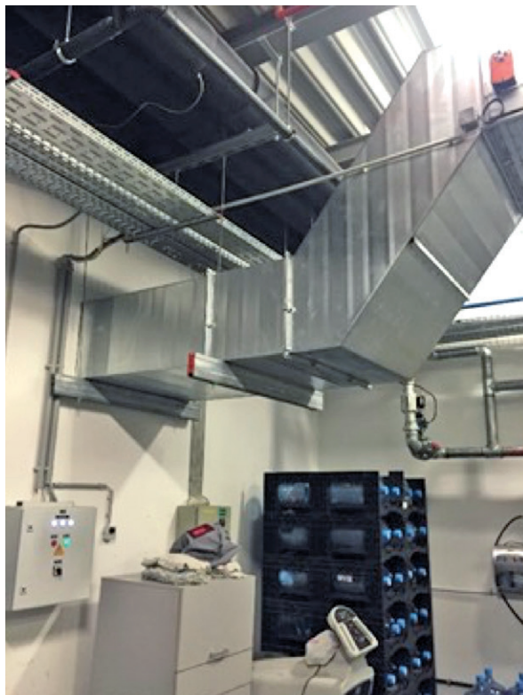
1. kép: A hűtőlevegő-csatorna bevezetése a gyártócsarnokba
