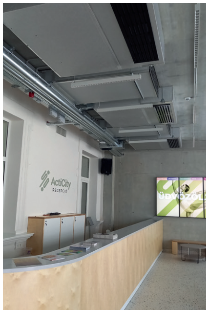
Látszó Fan-Coil berendezések
