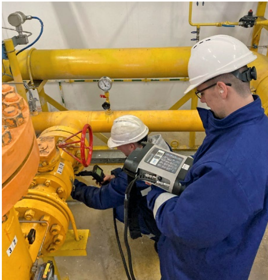
Áteresztő szerelvény keresése akusztikus műszerrel
