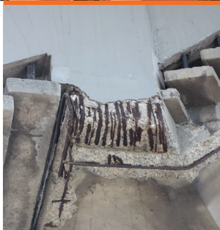
A főlépcső teherhordó vb. konzoljának betonkárosodása
