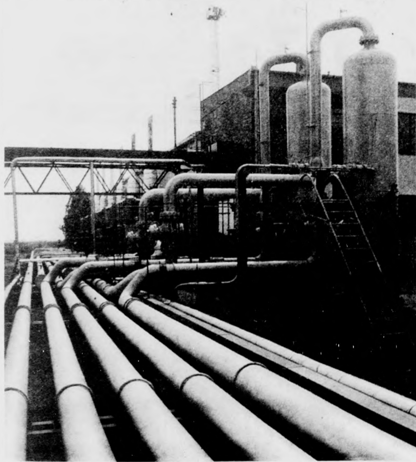
A földgázüzem új kompresszorháza a hozzá csatlakozó technológiai vezetékekkel
