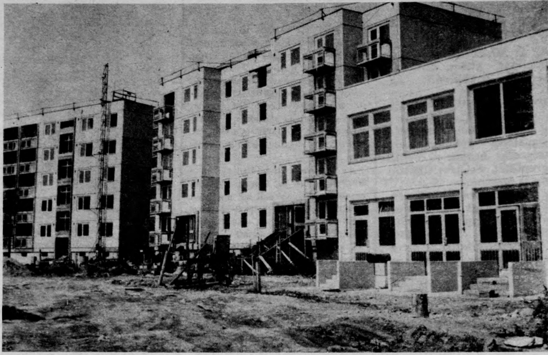
Képink a hajdúszoboszlói Szamely lakótelepen épülő házairól készült. A Hajdú megyei Állami Építőipari Vállalat 478 lakást épít itt, 178-át még ebben az évben át fogják adni (Kőszeghy György felvétele)
