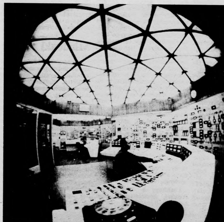
A visontai hőerőmű az első szovjet űrhajós, Gagarin nevét viseli. A képen a szovjet közreműködéssel épült erőmű központi kapcsolóterme. (Fotó: APN — KS)
