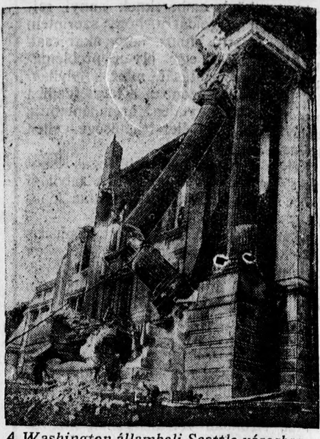
A Washington állambeli Seattle városban új bírósági épületre volt szükség, ezért a régit lebontották. A súlyos oszlopokat tehervocsikkal rántották ki helyeikről.
