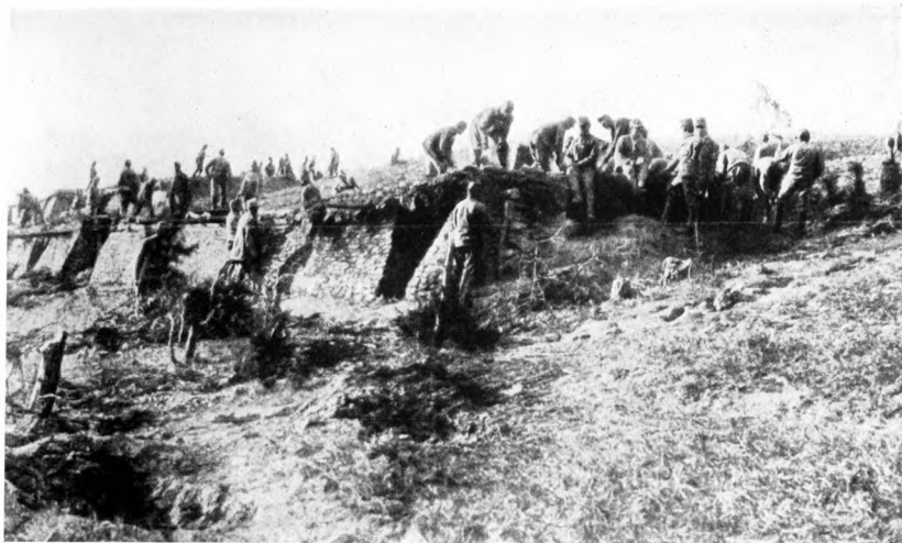
Bau von Unterständen des Inf.-Rgts. Nr. 56. — Az 56-ik gyalogezred fedezékének készítése. — Gradnja podzemnih stanova pješničke pukovnije broj 56. — Stavba krytá pěš. pl. řís. 56. — Budowa kwater podziemnych przez 56. pułk piechoty. — Clădire de senturi pentru regimentul 56 de infanterie. — Construction des abris du régiment d'infanterie No. 56. — Construction of shelters for the 56th infantry-regiment.
