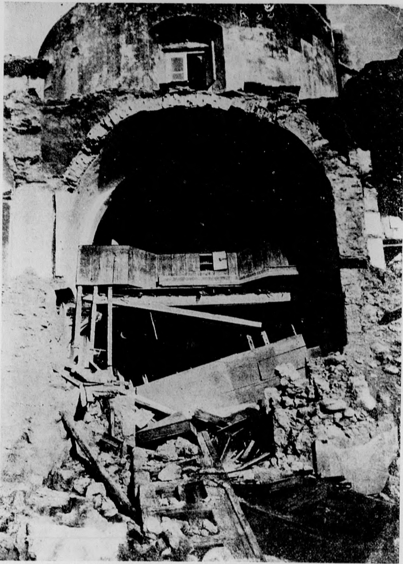
A messinai „Via Liberté”-n álló templom romjai. — A kövek alatt sok templomba menekült ember lelte halálát.
