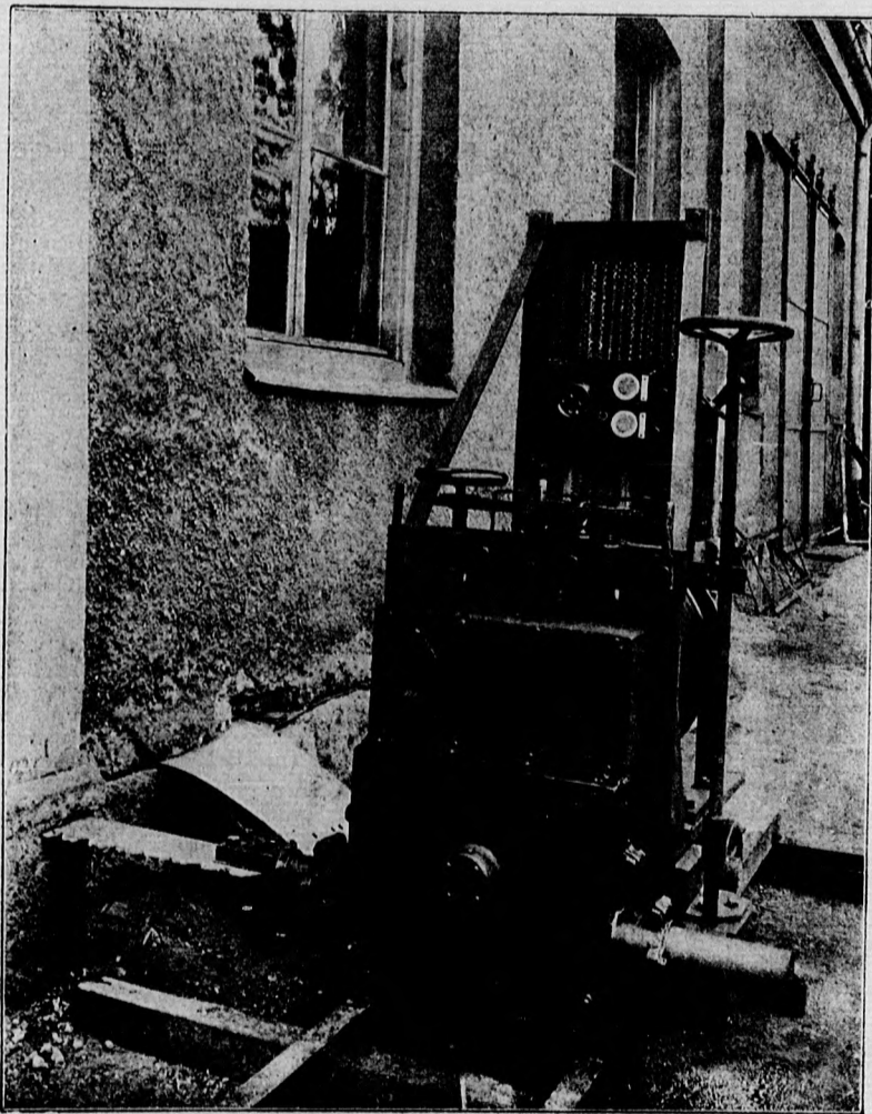
Das „Absägen“ der Heiligegeistkirche in München. (Mit Text.) Photographie W. Obergassner, München.
