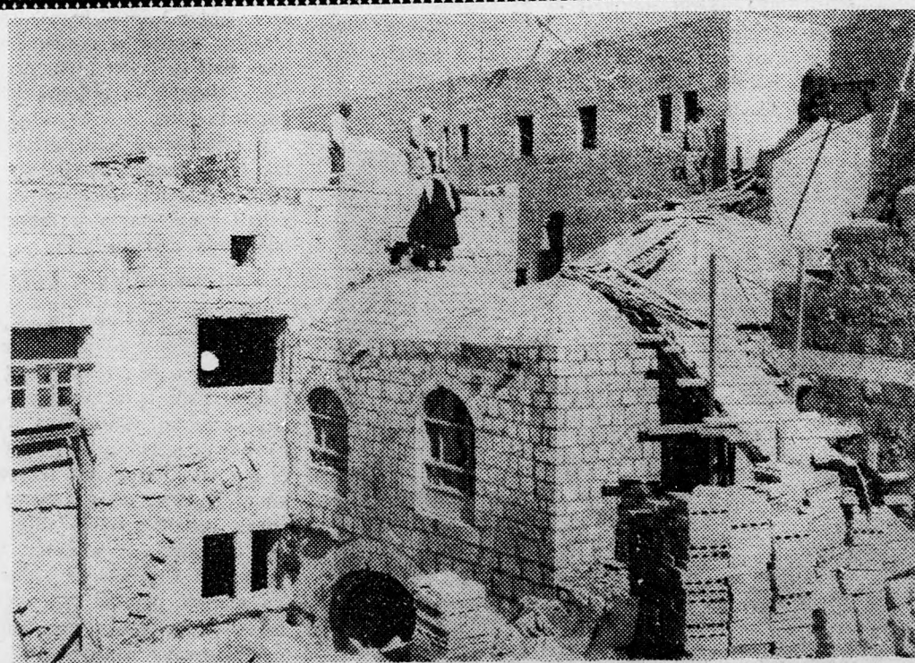
Jeruzsálemben, a Cion-heggyel szemben fekvő Jemin Mose-negyedet „művészvárossá” alakították át. Képünk a negyedben lévő Jochánán Bár Zákáj templom tatarozási munkálatait ábrázolja, zsidó és arab munkások részvételével.
